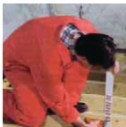
5 Pose des piges pour la mesure de l'épaisseur d'isolant lors du soufflage.
